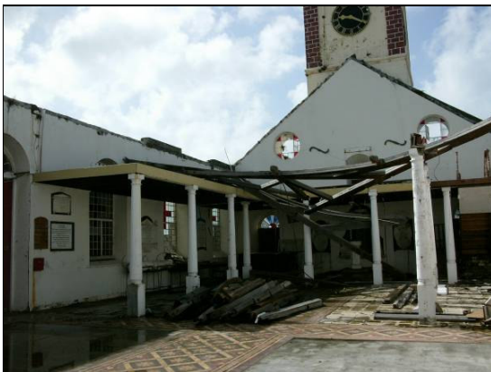
L'église date du 16 ème siècle. Il y a trois ans, un ouragan à emporté le toit... ils essaient toujours de trouver les fonds pour la restaurer. A cette occasion, 95% des maisons de Saint George ont été abattues. Elles sont aujourd'hui reconstruites à 80%.
